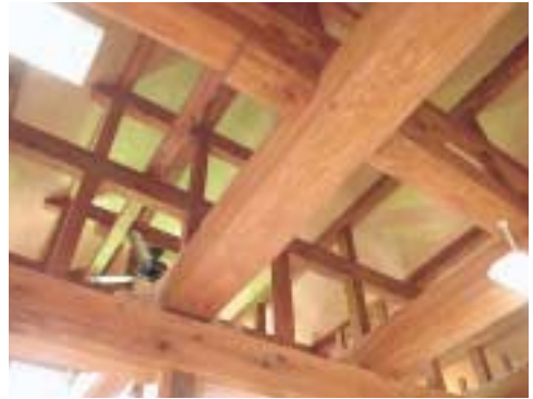
150年生の県産の杉材を利用した力強い梁。釘や金具を使わない伝統的な木組み技術を観察できる
